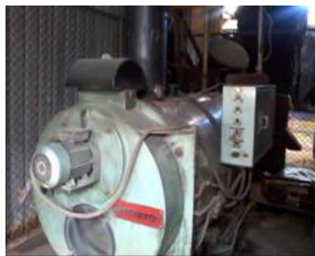
Caldera continental de 30 BHP Registro fotográfico del Concepto Técnico No. 00228 de 28 de abril de 2013
